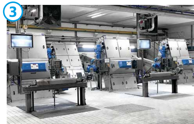
Kläranlage Vohburg Kläranlage Nürnberg
