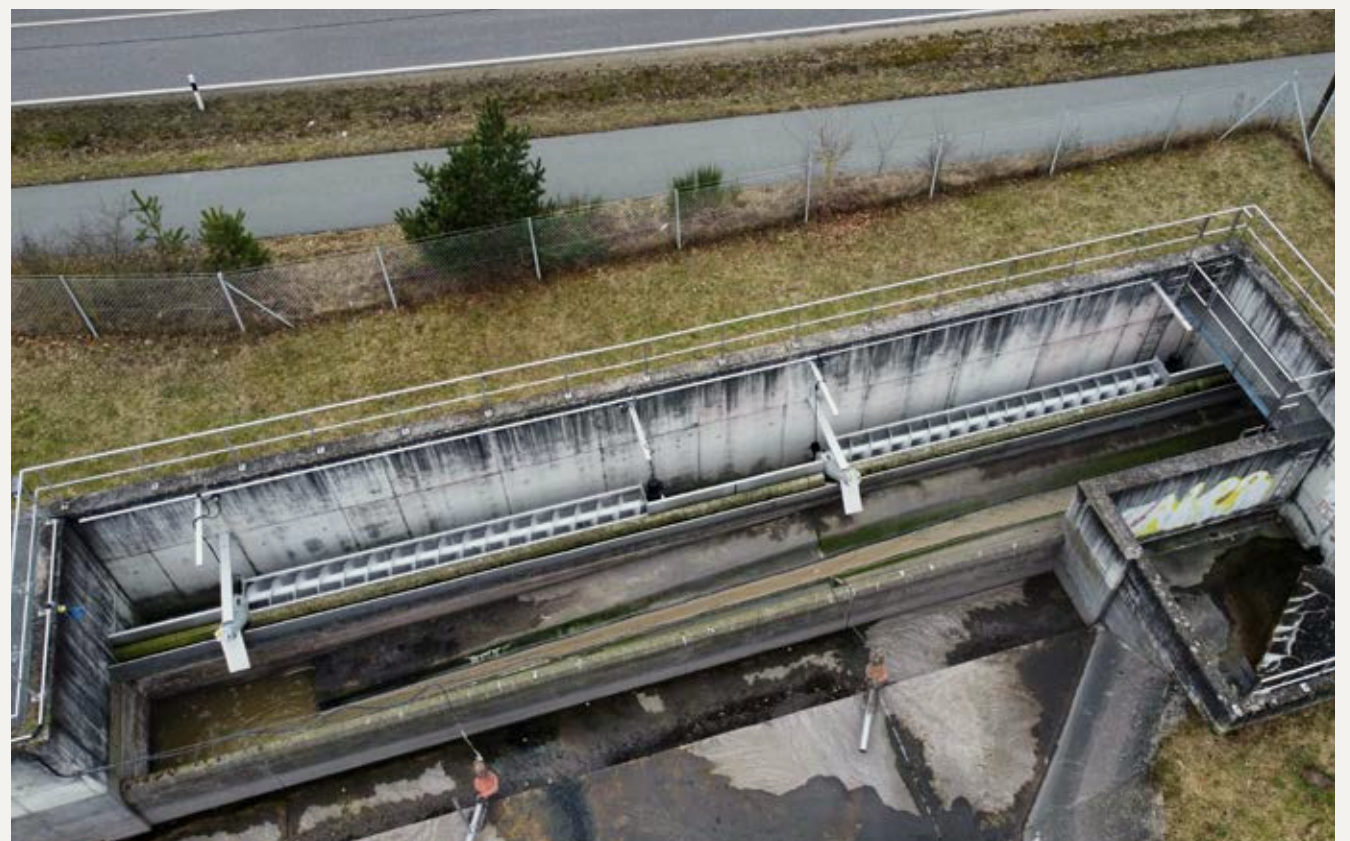
HUBER Siebanlage ROTAMAT® RoK1 beim Zweckverband zur Abwasserbeseitigung im Unteren Schwarzsachtal.
