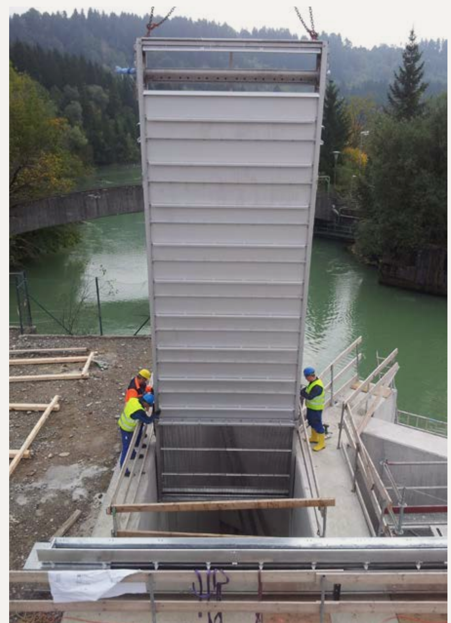
Installation eines HUBER RakeMax® in Schongau (Oberbayern).
