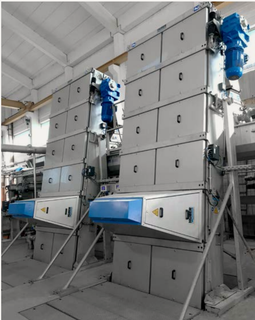
Innovativ und betriebssicher: Zwei der vier installierten HUBER Harken-Umlaufrechen RakeMax® mit Safety Vision im Klärwerk Regensburg.
