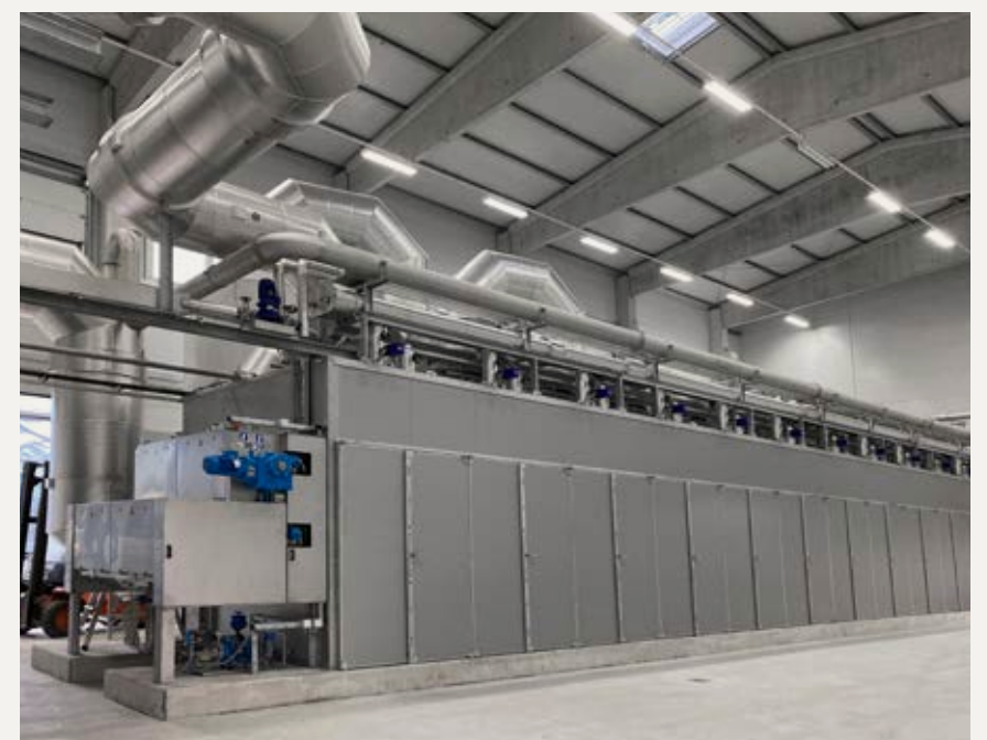
Seitenansicht des HUBER Bandtrockners BT 24 mit Wartungstüren.
