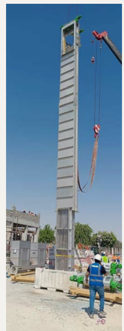
Einhub der HUBER Schalengreiferrechen TrashLift.
