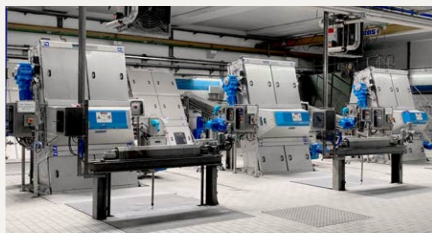
Die „Jubiläumsmaschine“ RakeMax® in ihrer Basisausführung im Hauptzulauf einer Kläranlage.
