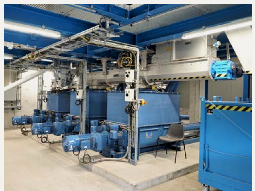
HUBER Trogförderschnecken Ro8 T transportieren den Klärschlamm.
