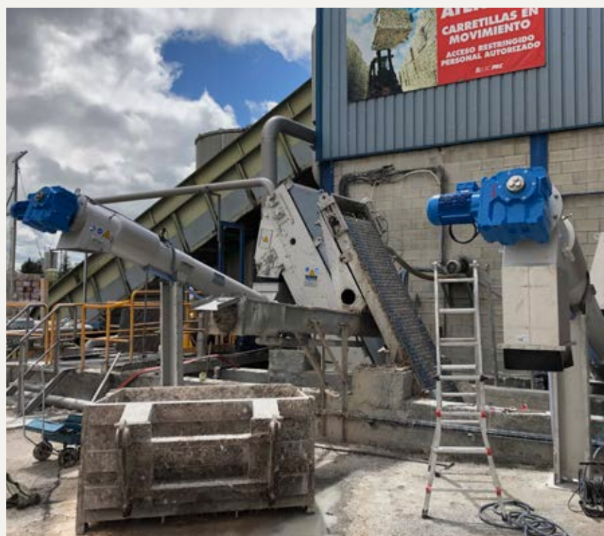
Mechanische Vorreinigung in einer spanischen Papierfabrik.
