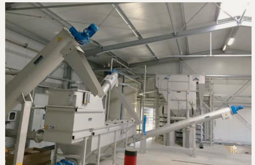
HUBER Kompaktanlage ROTAMAT® Ro5 und HUBER Druckentspannungsflotation HDF.
