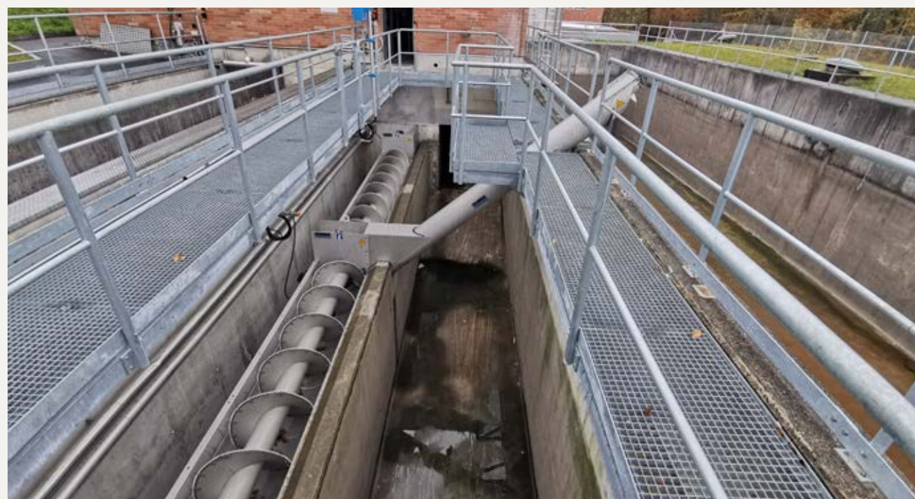
HUBER Siebanlage ROTAMAT® RoK1 TS auf der ARA Zumikon (Schweiz).
