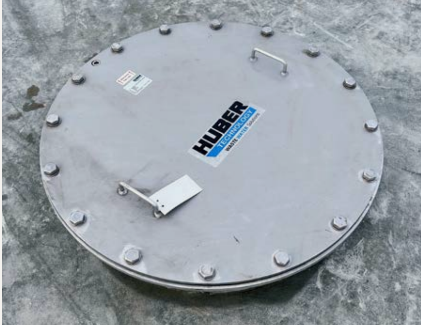
Auf der Decke der Reaktorkammern verbaut: Die druckdichten HUBER Mannlöcher TT8a sind bis zu einem Gasdruck von 40 mbar beständig.
