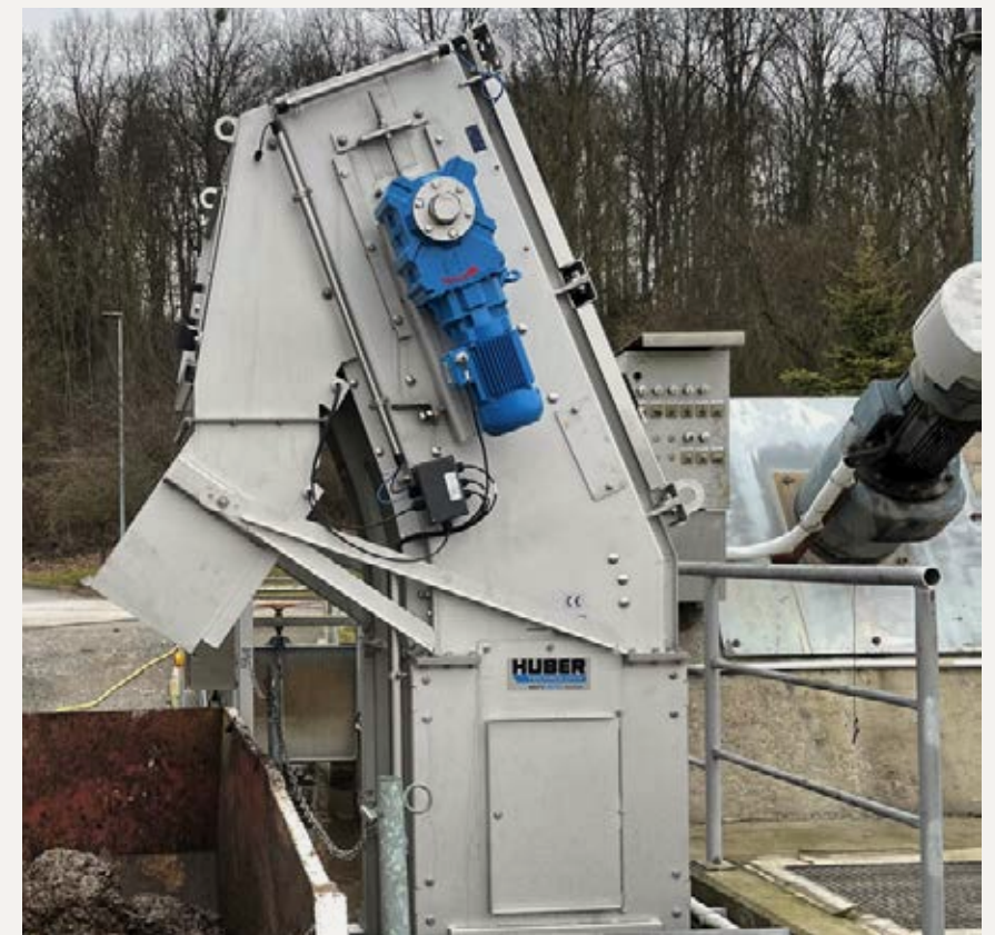
Der HUBER Harken-Umlaufrechen RakeMax® CF vereint die Vorzüge des bewährten RakeMax® mit den positiven Eigenschaften eines Center Flow-Rechens, hier eingebaut zur Siebung von Rücklaufschlamm.
