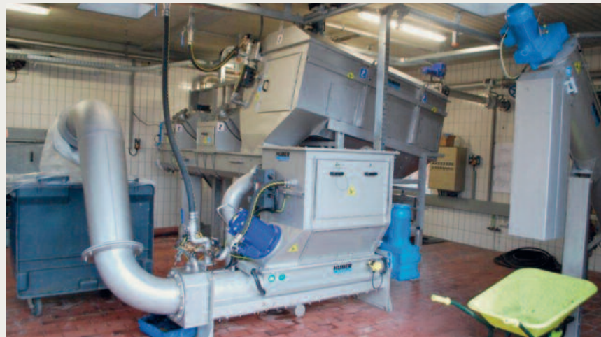
HUBER Waschpresse WAP®SL für die Behandlung der abgetrennten Feststoffe
