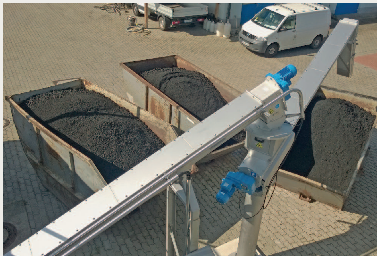
Abbildung 2: Lösung für Klärschlammtransport 20.000-50.000 EW Schwenkbare Aufgabeschnecke mit manuell stellbarer Schurre auf der KA Hausen für diverse Containergrößen und Anordnungen.
