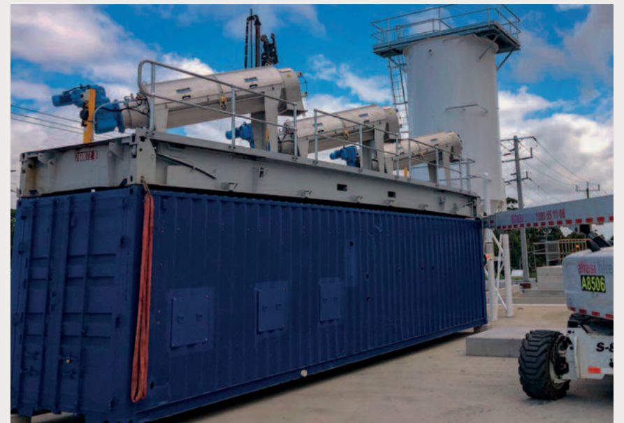
Oberirdische Aufstellung des TunnelMax® Verfahrens mit HUBER Schneckenpresse Q-PRESS® (Bildquelle3)
