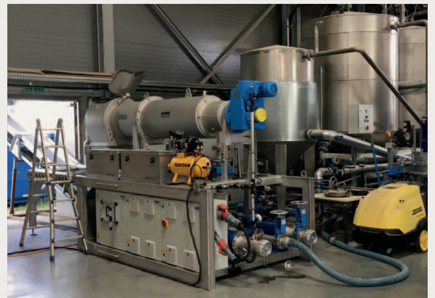
Abb. 3: STRAINPRESS® 430 Vorführanlage zur Gärrestsiebung
