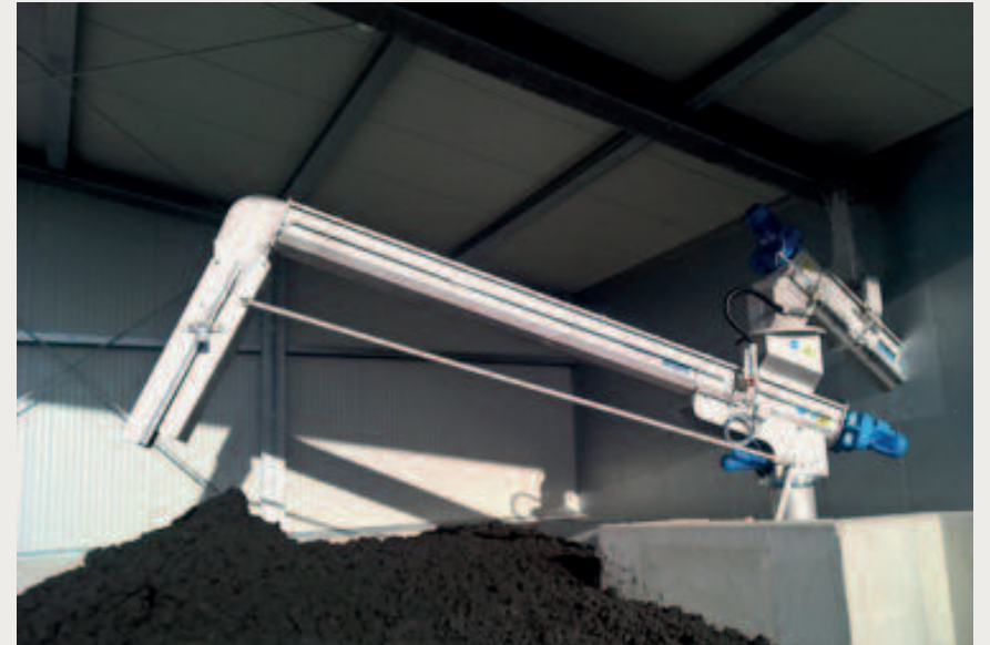
Abbildung 3: Optimale Ausnutzung der Schlammlagerkapazität auf der KA Ebensfeld.
