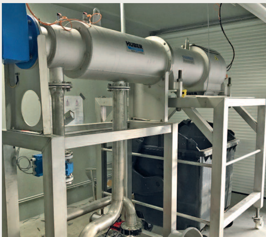
Erhöhter Einbau der HUBER Fremdstoffabscheider STRAINPRESS® 290 in eine Fertigarage
