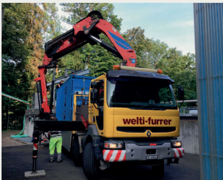
Abb. 1: Anlieferung der Versuchsanlage auf der Ara Sihltal. Maßarbeit war bei der Installation der Anlage gefragt
