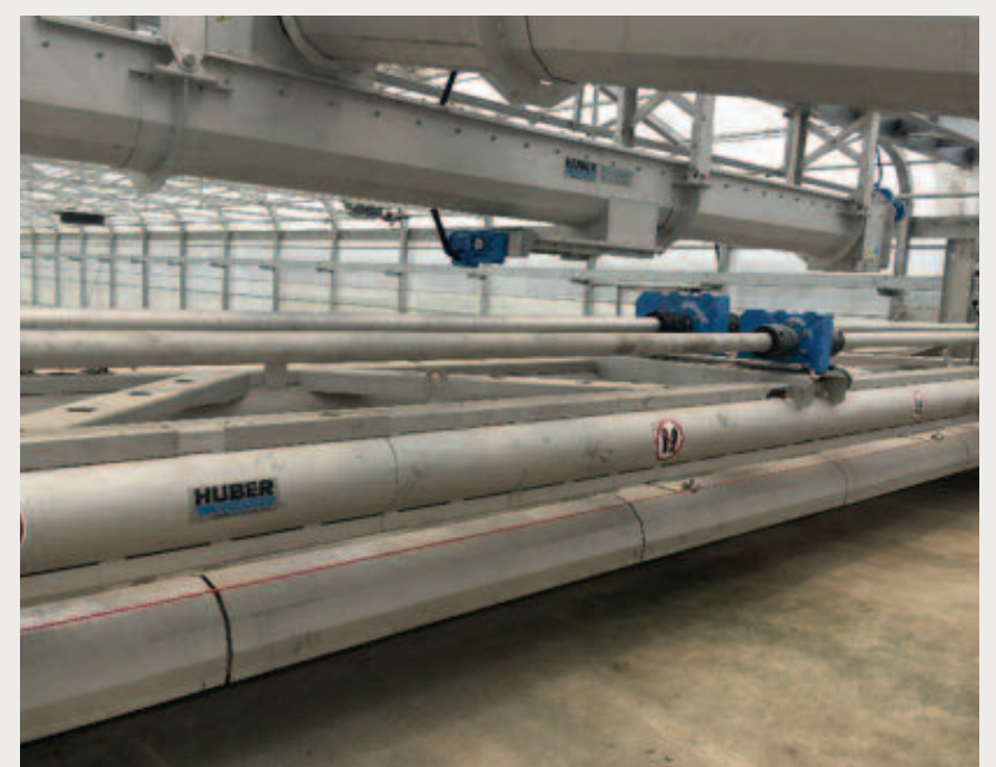
Schlammwender SOLSTICE® installiert im Gewächshaus
