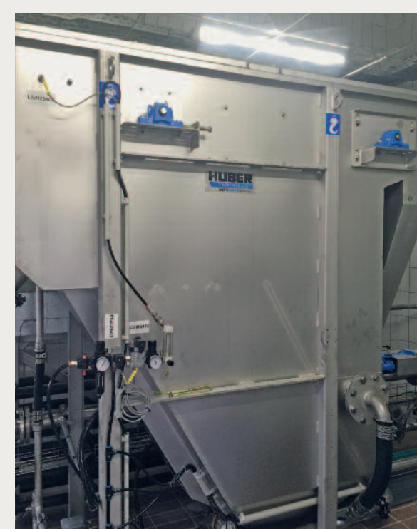
Kompakt installierte HDF am Standort St. Erasmus/Waldkraiburg
