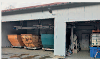
Schlammaustrag in Großcontainer mit HUBER Fördertechnik
