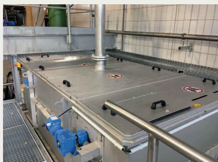
Flotationsbehälter der HDF am Standort Oberding mit Abdeckung und Absaugung unangenehmer Gerüche
