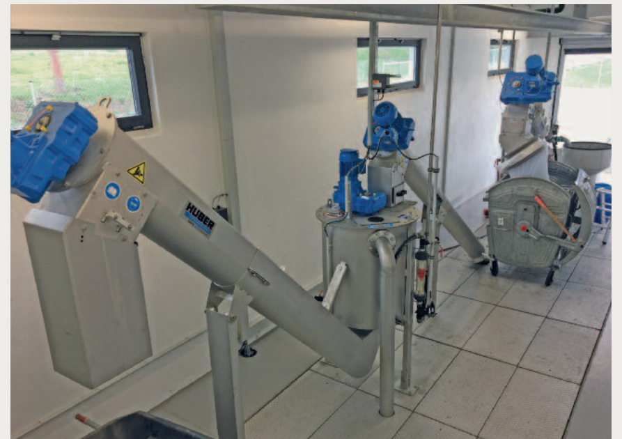
Sandwaschanlage RoSF4 T, Kompaktanlage ROTAMAT® Ro5, Fettabtropfbehälter
