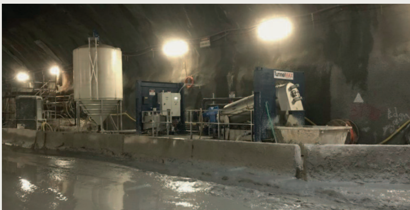
Unterirdische Aufstellung der Schneckenpresse Q-PRESS® zur Entwässerung von Schlämmen aus dem Tunnelbau (Bildquelle2)
