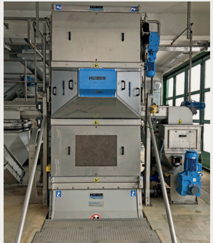
Auf der Kläranlage in Neumarkt in der Oberpfalz läuft die HUBER Störstofferkennung Safety Vision zur höchsten Zufriedenheit des Betreibers.
