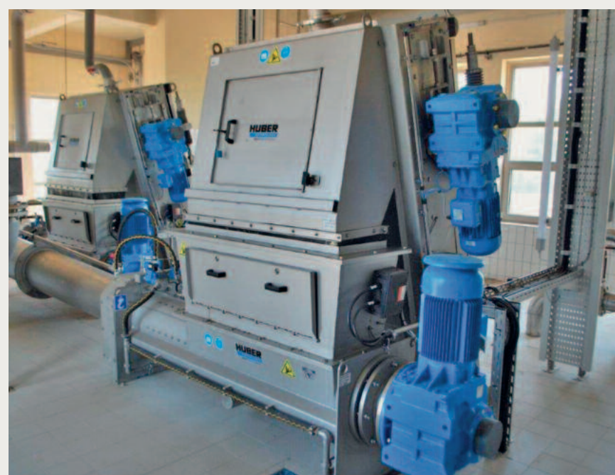
Rechengutabwurf von den beiden RakeMax® in die jeweilige Waschpresse WAP® 6
