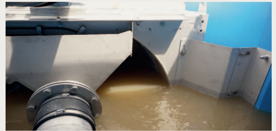
Abb. 5: Blick in Fließrichtung in die gefüllte Zulaufkammer und in das Trommelsieb mit Auffangtrichter und Siebgleitung
