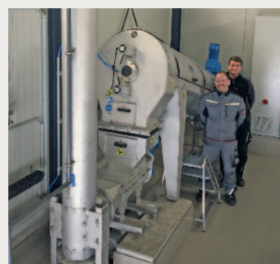
Betriebsleiter H. Beyer und H. Kropf bei der neuen Schlammmentwässerung mit HUBER Schneckenpresse Q-PRESS® 440.2 und nachgeschalteter Schlammaustragsfördertechnik Ro8 in platzsparender vertikalen Einbauvariante
