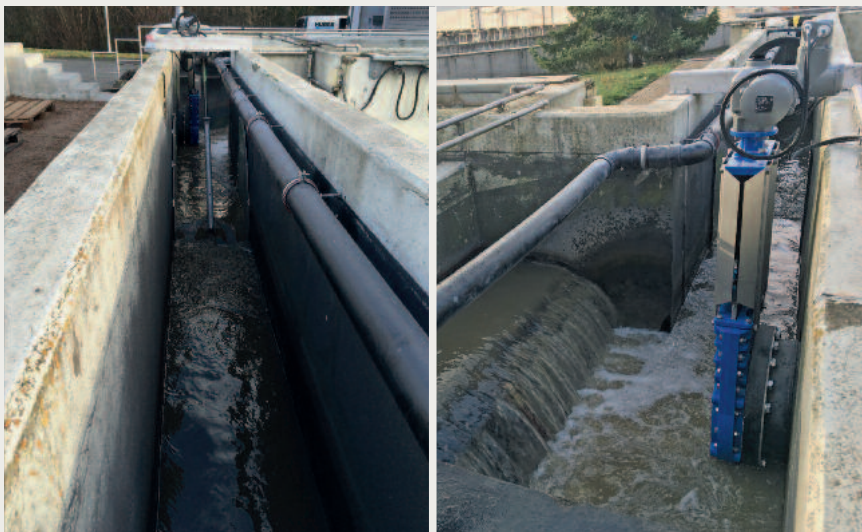
Bild links: Nachgeschalteter Absenkschieber vor dem Venturikanal für max. Betriebssicherheit bei Stoßbelastungen. Bild rechts: Auslauf Sandfang mit der Möglichkeit eines geregelten Zulaufs über Regelschieber zum HUBER Trommelsieb LIQUID
