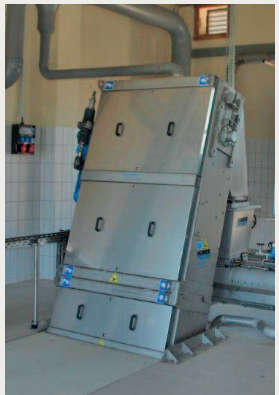
Harken-Umlaufrechen RakeMax® und Gerinne geruchsgekapselt mit Abluftabsaugung
