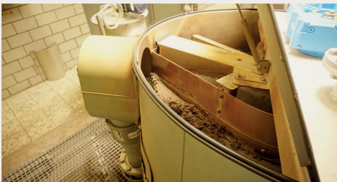
Abb. 8: Eindickung des Siebgut- / Überschussschlammgemisch mit dem bestehenden HUBER Scheibeneindicker S-DISC. Blick auf den eingedickten Schlamm
