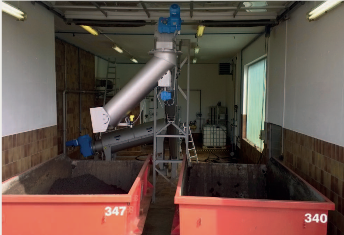
Abbildung 1: Lösung für Klärschlammtransport <20.000 EW: Einfache Rutschlösung mit händisch zu bedienenden Stellmotor als Beschickungslösung für zwei Container.
