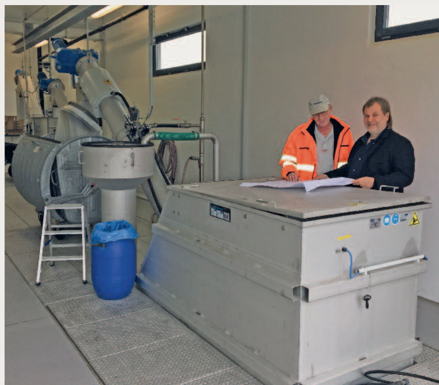
Herr Liebler und H. Harth (Ing. Büro) bei der Begutachtung der neuen mech. Vorreinigung
