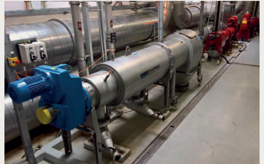
Abb. 2: STRAINPRESS® 430 installiert anstelle der kleinen Vorgängermodelle (im Hintergrund)
