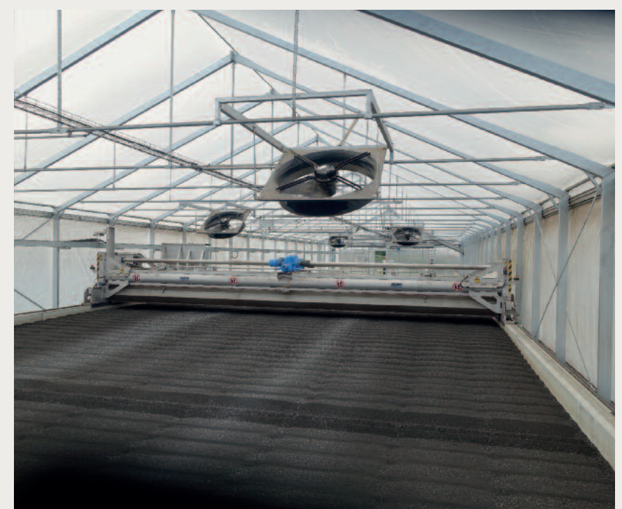
Bild 3: Solare Klärschlamm-trocknung HUBER SOLSTICE® in Freystadt
