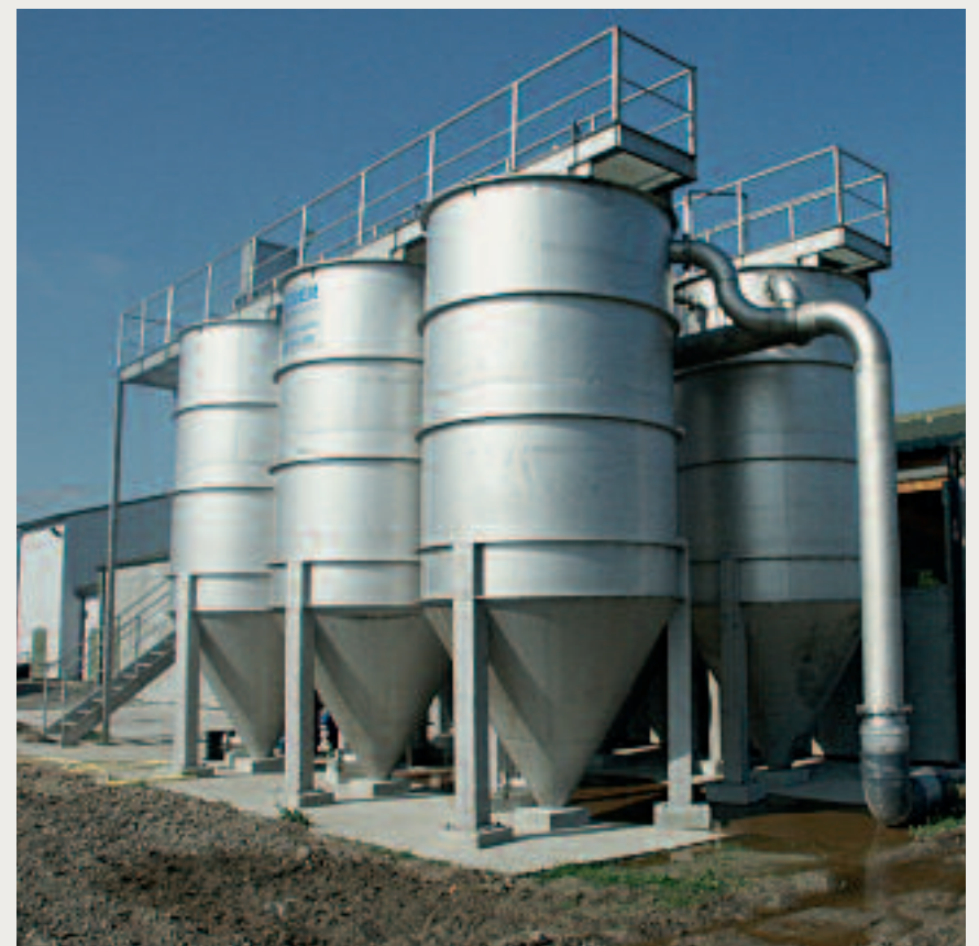
Großtechnische Filtrationsanlage - 6x HUBER Sandfilter Contiflow® CFSF 51
