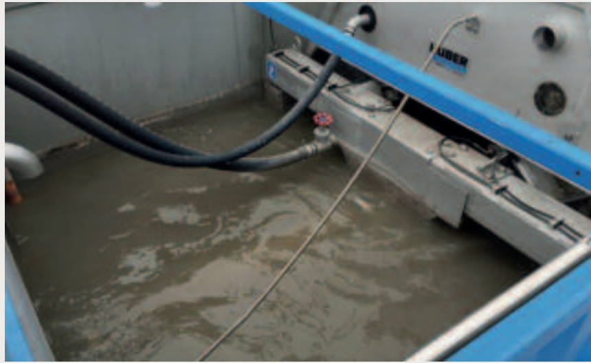
Abb. 7: Zulauf bei max. Wasserspiegel vor dem HUBER Trommelsieb LIQUID
