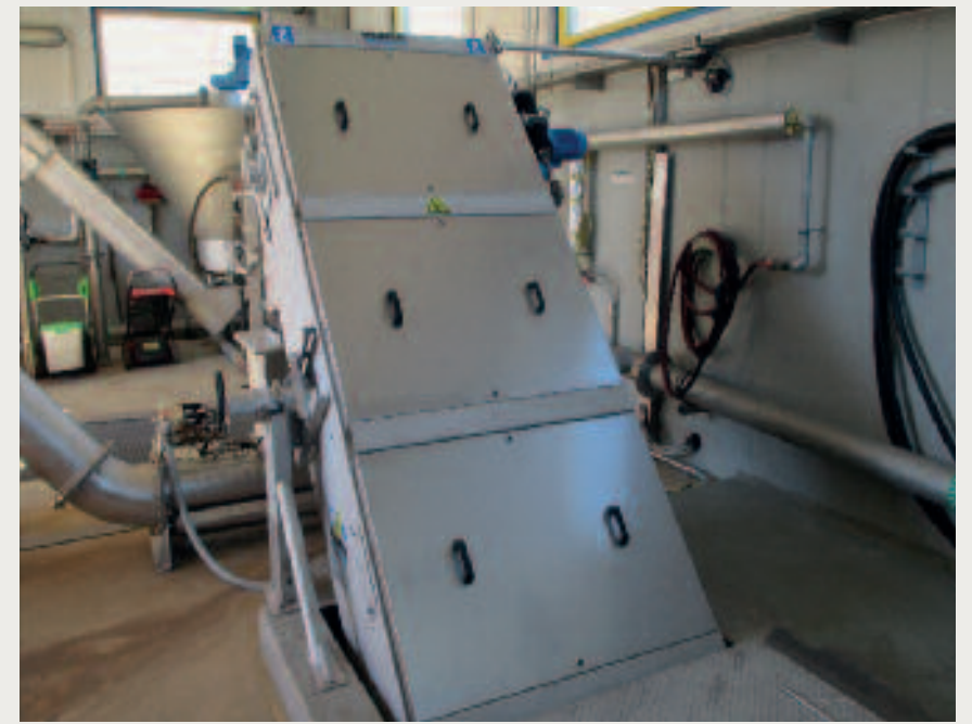
Der HUBER Harken-umlaufrechen RakeMax® Hybrid direkt in das Zulaufgerinne der Kläranlage eingebaut.
