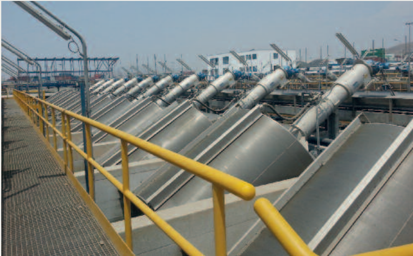
Mehrere HUBER Siebanlagen ROTAMAT direkt eingebaut in die Gerinne der Kläranlage.
