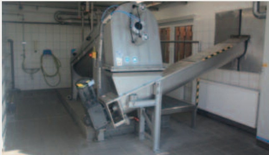
Schlammentwässerung nach dem Umbau: Komplette maschinelle Schlammentwässerung mit Schneckenpresse Q-PRESS® 440
