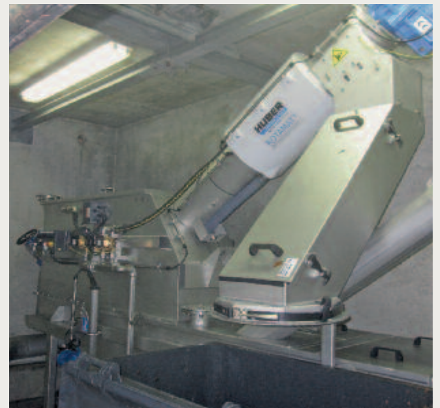
Zulaufbereich der HUBER Kompaktanlage ROTAMAT® Ro5
