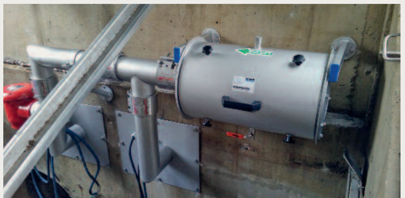
Die HUBER Luftfilteranlage sorgt für eine saubere Be- und Entlüftung im Trinkwasserspeicher
