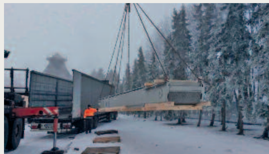
HUBER Harken-Umlaufrechen RakeMax® im Anflug an seinem Einsatzort.
