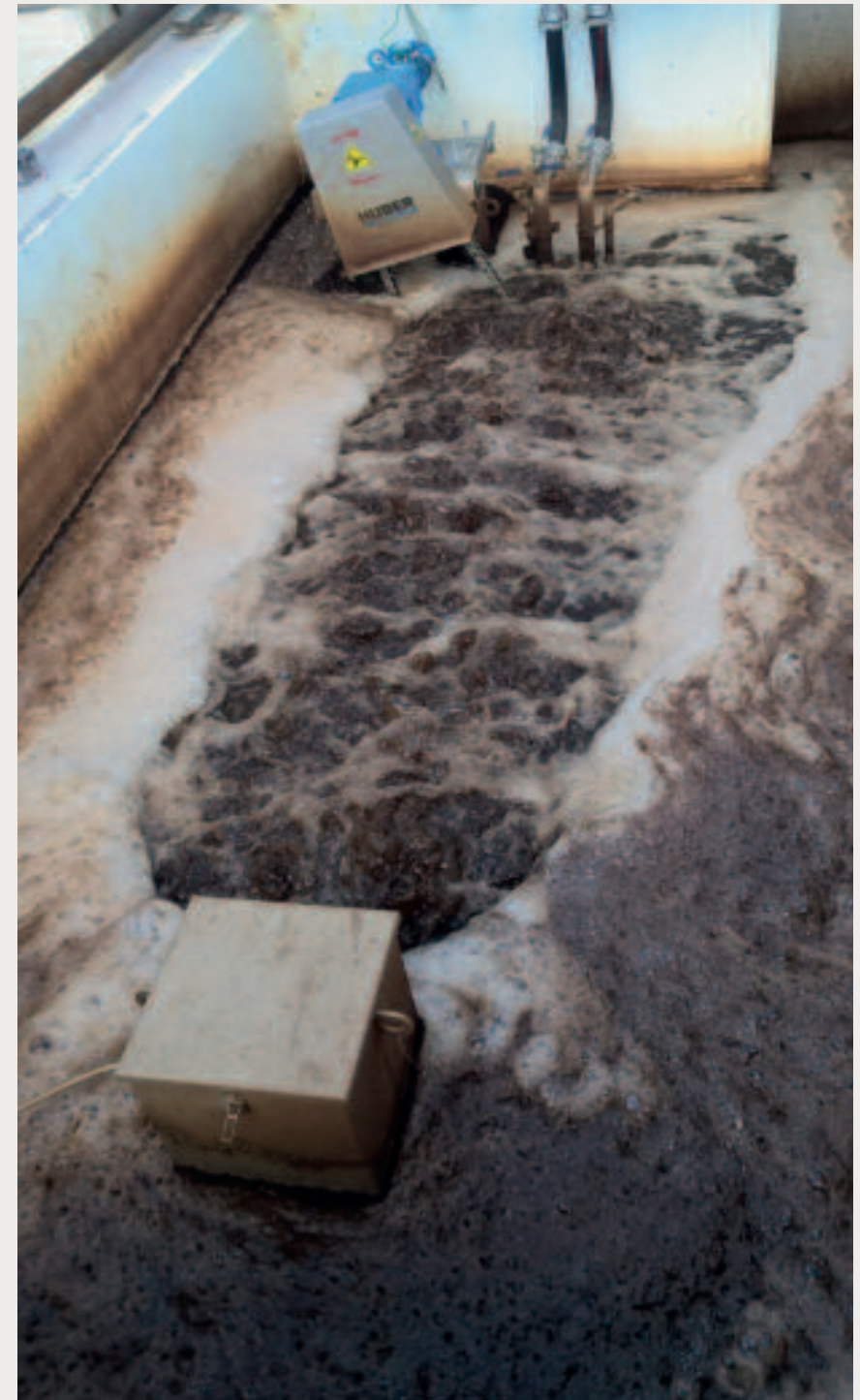
Filtrationskammer der HUBER Membranfiltration VRM® 20
