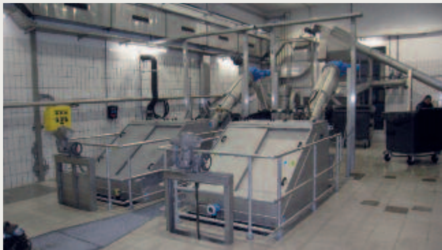
Der Rechenraum mit den zwei parallel eingebauten HUBER Siebanlagen ROTAMAT®
