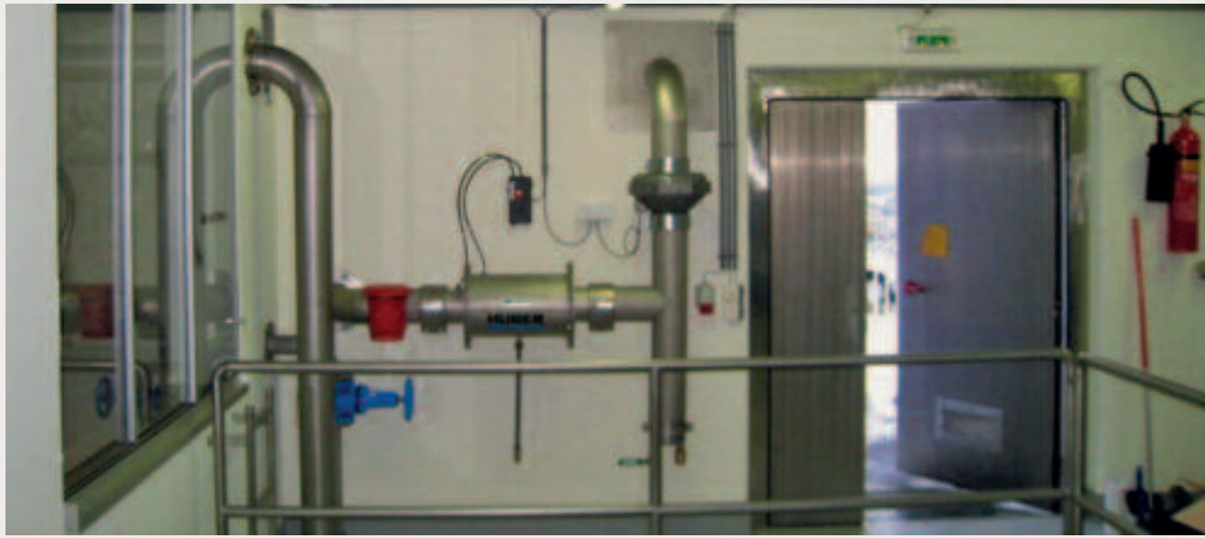
Einsatzbeispiel der „Aktiven Zwangsbelüftung“ am HB Utzenaich in Österreich
