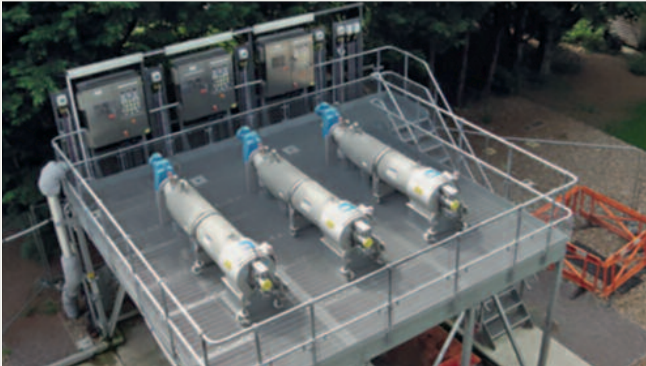
Freiluftaufstellung von drei HUBER Fremdstoffabscheider STRAINPRESS® 290
