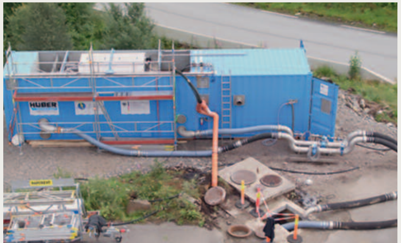
Versuchsdurchführung Trommelsieb LIQUID im Container in Norwegen
