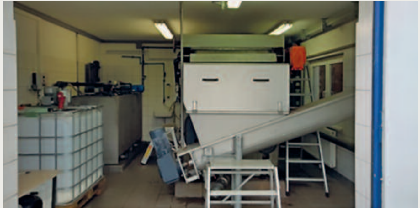
Schlammentwässerung vor dem Umbau: Komplette maschinelle Schlammentwässerung mit Siebbandpresse
