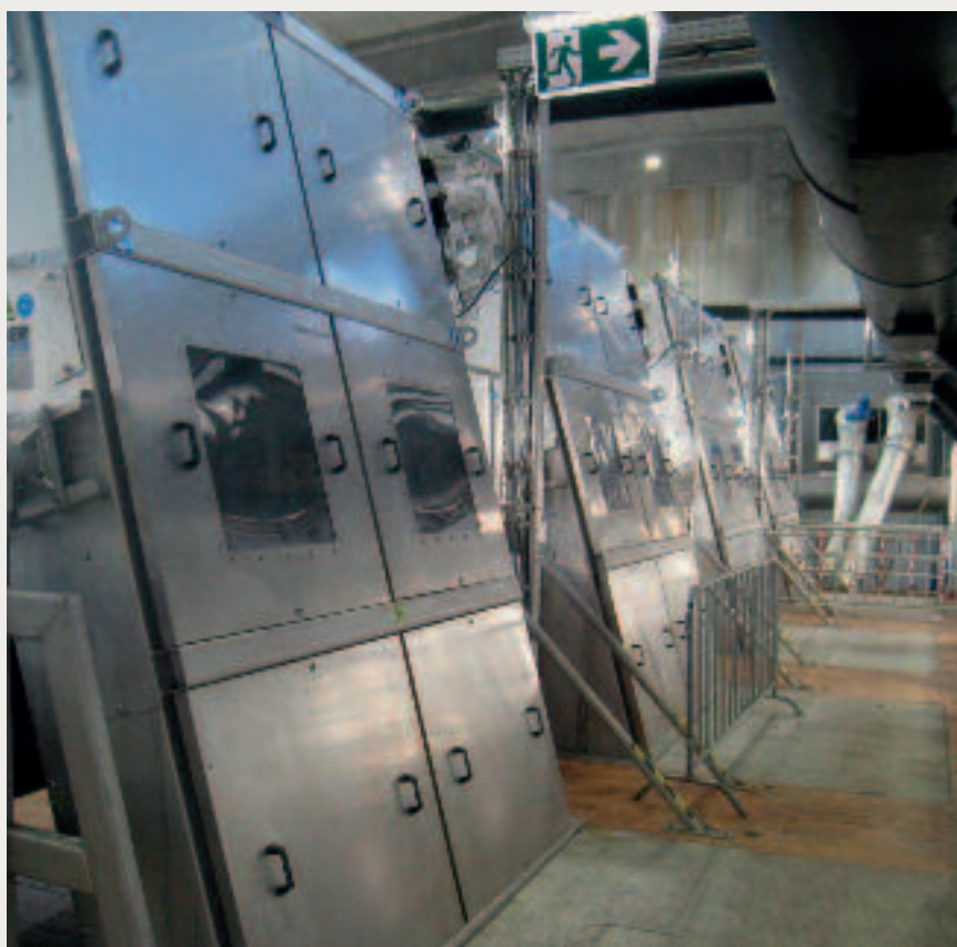
Modernste HUBER Maschinenteknik auf der größten oberösterreichischen Kläranlage Linz-Asten.
