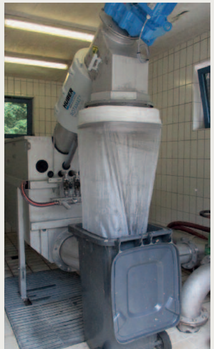
HUBER Siebanlage ROTAMAT® Ro2 als Behälterausführung eingebaut in das beengte Rechenhaus der Kläranlage
