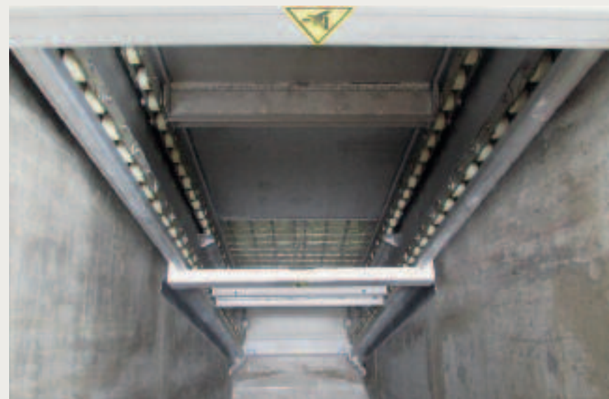
Die Vorderseite des Rechenfeldes vom HUBER Harken-Umlaufrechen RakeMax®
