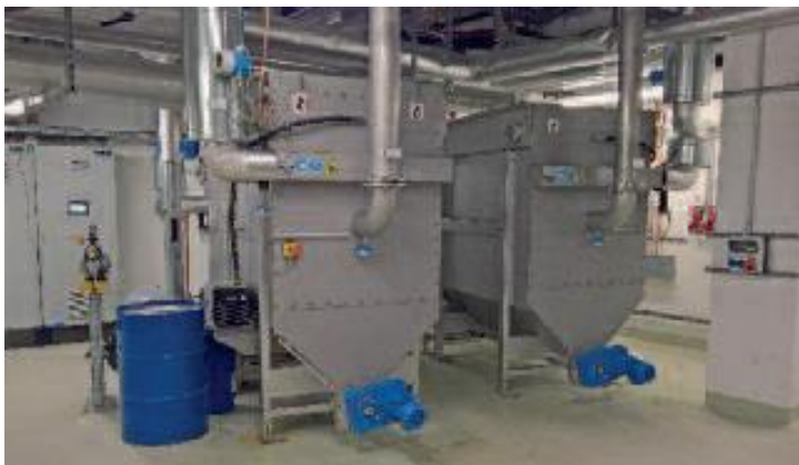
Abbildung 32: Abwasserwärmenutzung - das Museum „Haus der Bayerischen Geschichte“ (Bild oben) in Regensburg nutzt das HUBER ThermWin Verfahren mit den HUBER Abwasserwärmetauschern RoWin (Bild unten) zum Heizen und Kühlen des Gebäudes. Damit werden fossile Energieträger durch regenerative Abwasserenergie ersetzt.
