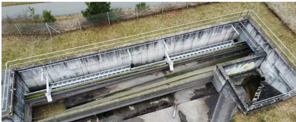
Abbildung 29: Ein Entlastungsbauwerk mit HUBER Siebanlagen ROTAMAT® RoK1 TS, welche auch bei Starkregen in Verbindung mit großen Rechengutmengen betriebssicher funktionieren.
