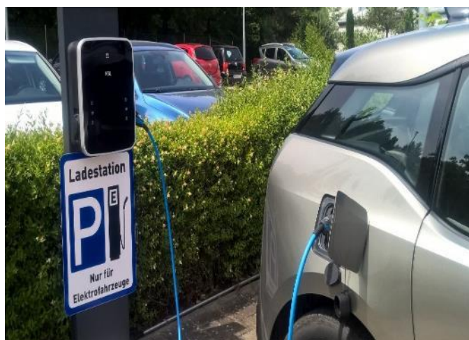
Abbildung 14: Eine von insgesamt 6 Stromtankstellen auf dem HUBER Firmengelände. Hier können Kunden aber auch Mitarbeiter ihre Elektrofahrzeuge aufladen
